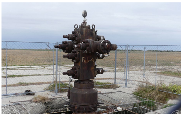
5. ábra. A Fábiánsebestyén-4. kút kútfejszerelvénye a karácsonyfával
