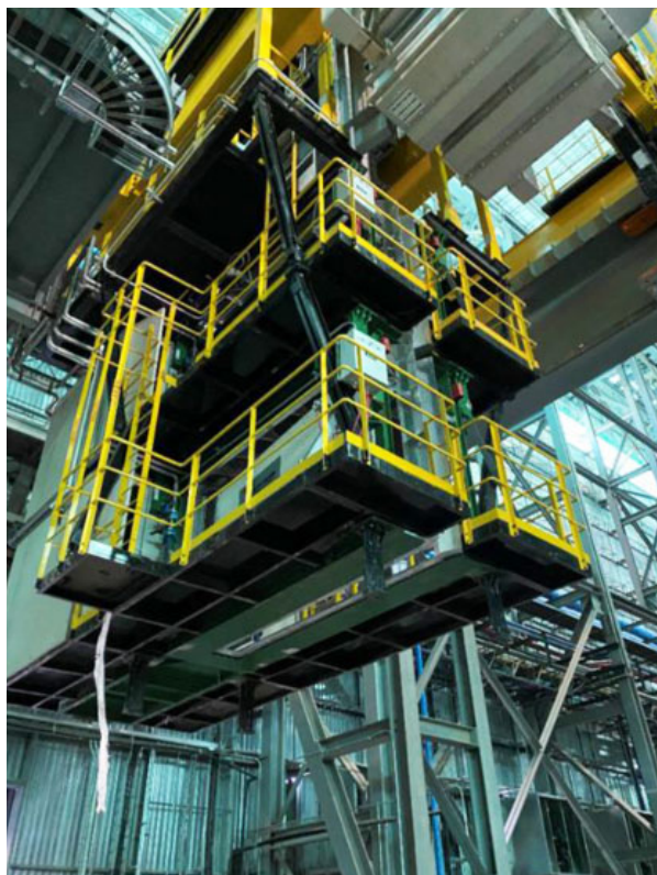
5. ábra. Galvanneal lágyító kemence (2 zónás, sínen ki-be mozgatható a horganyozó kád felett)
