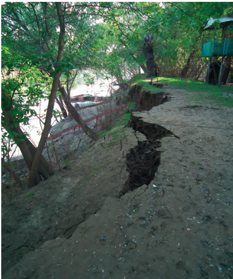
4. kép A partszakasszal párhuzamos, a növények gyökerei mentén előrejelzett repedések (Fotó: KIS MOLNÁR I.) Picture 4 Cracks parallel with the bank performed by tree roots (Photo by KIS MOLNÁR, I.)
