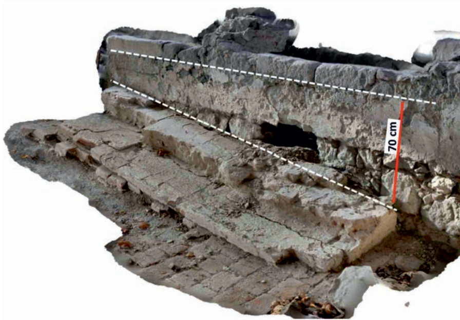
11. ábra. Megsüllyedt és megdőlt lépcsőfokok a kerengő nyugati falánál. A lépcső a refektóriumba vezetett. A lépcső teteje eredetileg a vízszintes, szaggatott vonal magasságában volt; onnét süllyedt 70 cm-t. A háromdimenziós modell a structure-from-motion technikával készült. A 6. ábra 11. sz. lefolyhelye. ADB #6724
