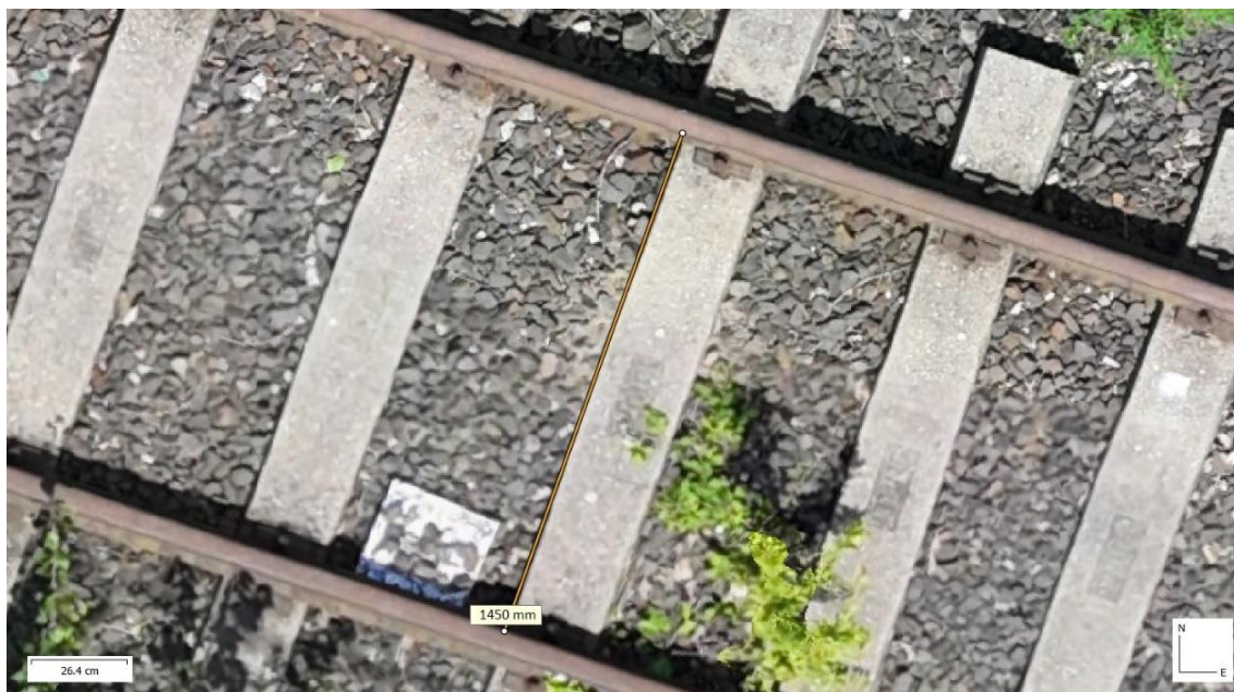
10. ábra A vágányközbe helyezett nem oda illő tárgy (Forrás: saját felvétel)
