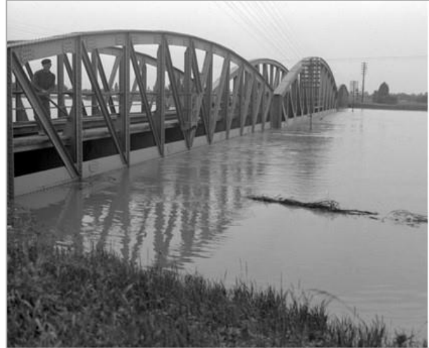
2. kép. Árad a Fehér-Körös, a gyulai híd alsó övlemezei már félig vízben állnak (Szlávik 1976a)
