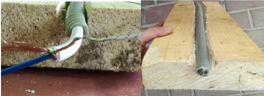
4. Kép: PVC szigetelésű három eres kábel fenyőfa gerendába elvezetve gégecsőben
