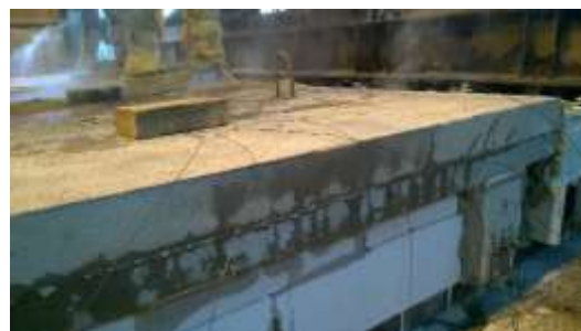
b) a felbeton elválása
