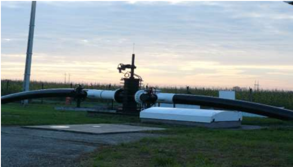
3. ábra. BT termék távvezeték-szakaszoló állomás. Forrás: Mol Nyrt LOG, készítette: Jeruska József.
