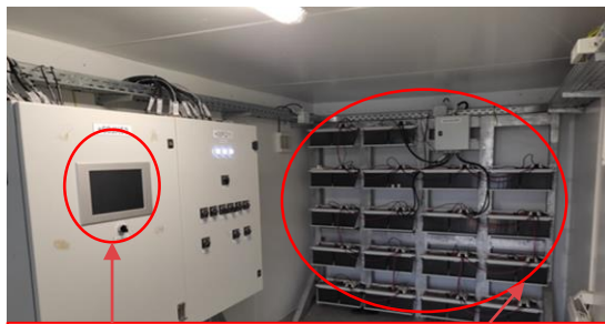
PLC vezérlés, akku telepek
