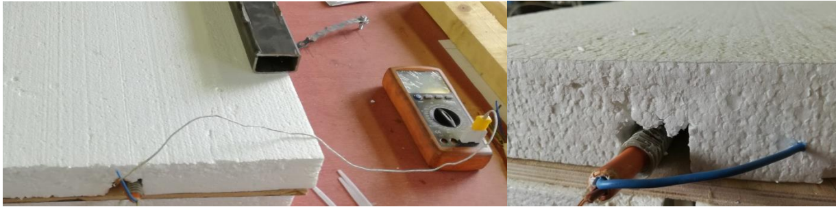
6. Kép: NhXh-J3x1,5 E90-es tűzálló kábel EPS szigetelésben gégecsőben elvezetve
