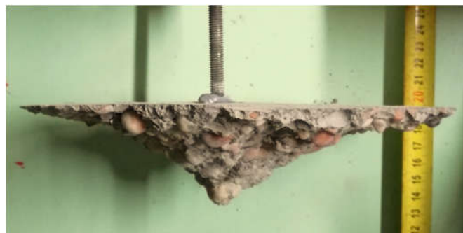
10. ábra. – Kúpszerű kiszakadás tűzkárosodott betonban
